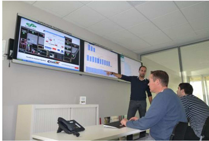
Salle de supervision du dispositif Opti Energie proposé par Cesbron pour réduire les consommations d'énergie de ses clients
