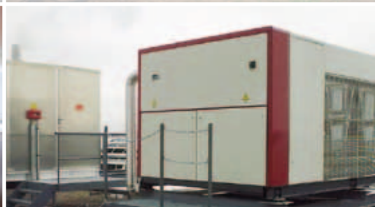
Chaufferie et groupe d'eau glacée en terrasse
