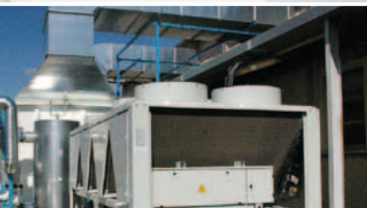
Groupe et caisson de traitement d'air
